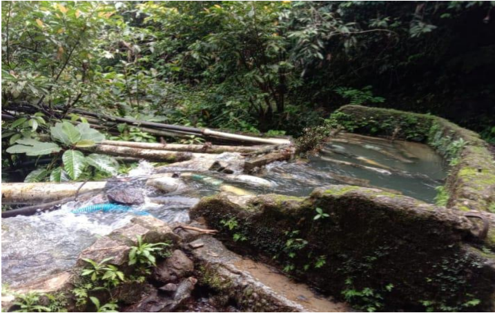
Gambar 2. Kondisi Dam Kata Lima saat ini (2023).
