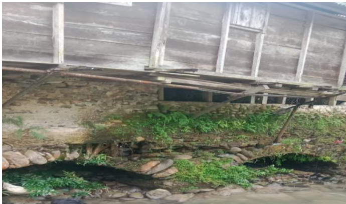
Gambar 2. Tiang Penahan rumah warga yang melekat pada beronjong (Sumber: Dokumentasi peneliti, Tahun 2023)
