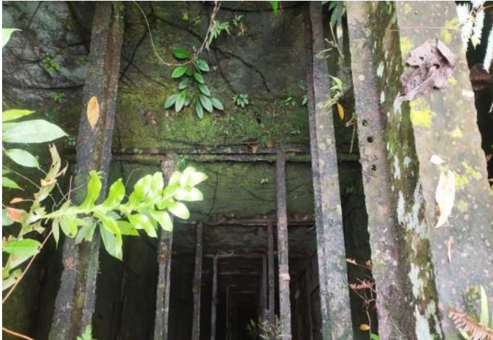
Gambar 2. Kondisi Besi Lubang Derek yang sudah keropos.
