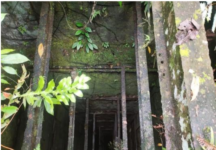
Gambar. Kondisi Beesi Lubang Derek yang sudah Keropos
